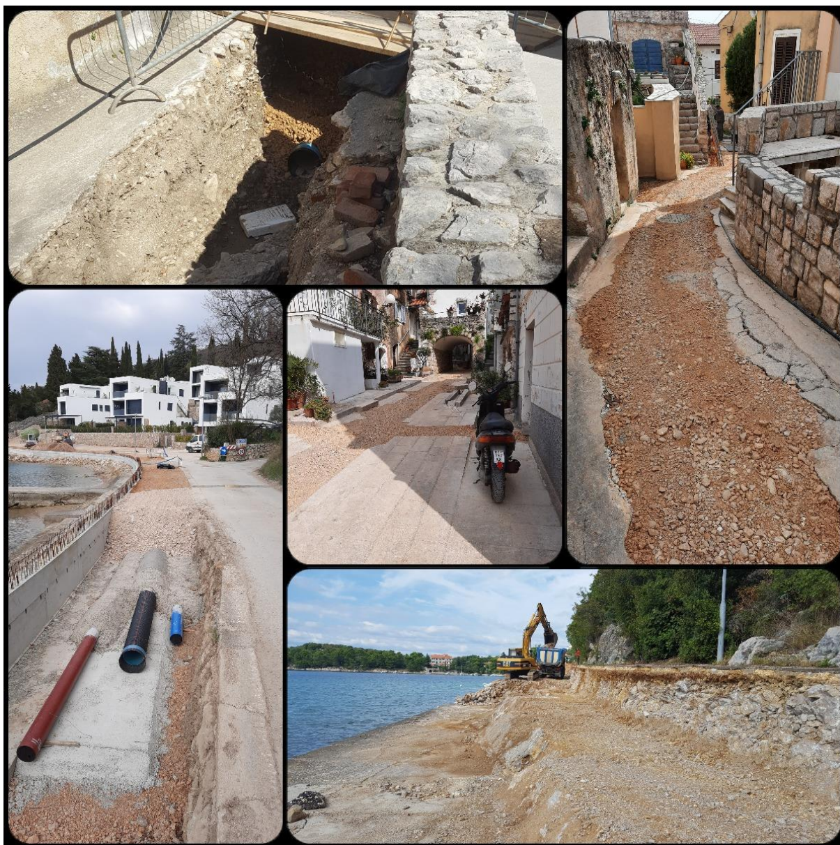
Slika: Radovi na izgradnji u sklopu "Projekta prikupljanja odvodnje i pročišćavanja otpadnih voda otoka Krka"
