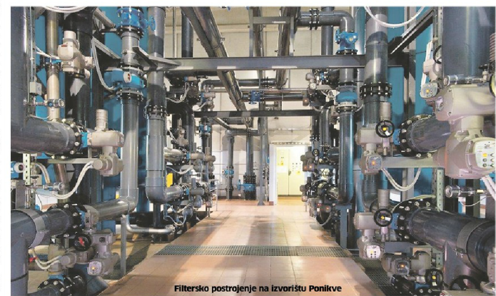
Filtersko postrojenje na Izvoristu Ponikve
